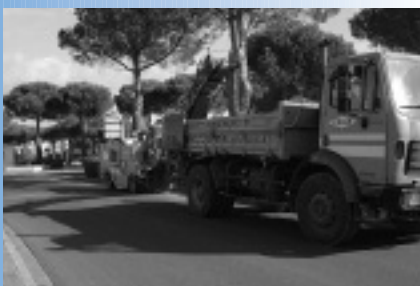
▲ Port Rive Droite : réfection de la chaussée du boulevard de la Corderie soulevée par les racines des pins.
